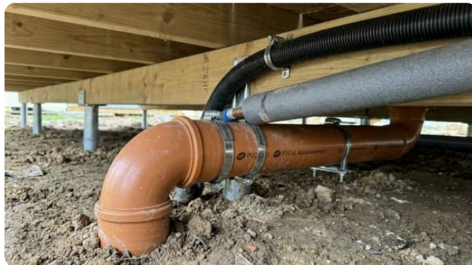
Sous la maison : évacuation PVC Ø 110 mm, gaine électrique et arrivée d'eau calorifugée contre le gel, fixées sous le plancher.
